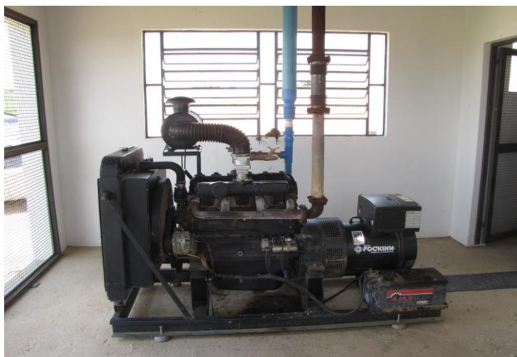
Moto-gerador à Biogás de 85 kVA
